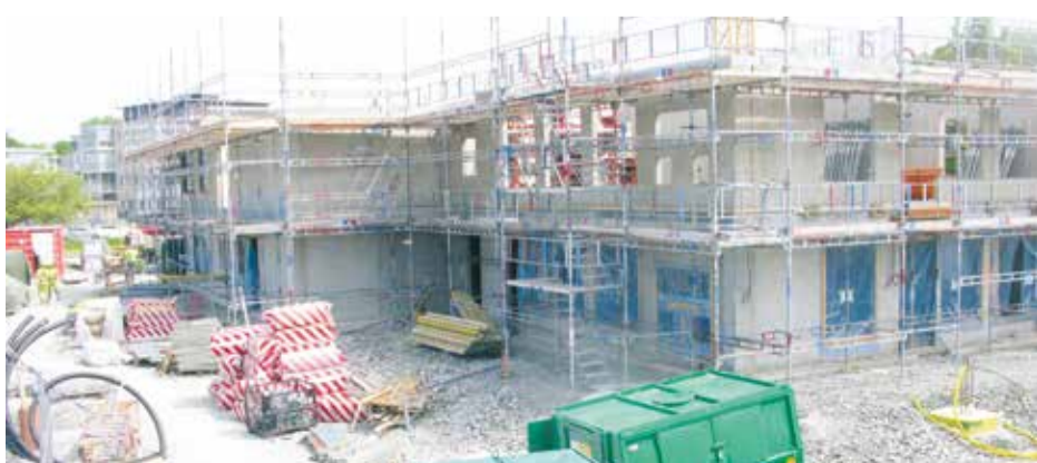
Ängslyckans förskola växer just nu fram i centrala Hjärup med plats för 270 barn.
