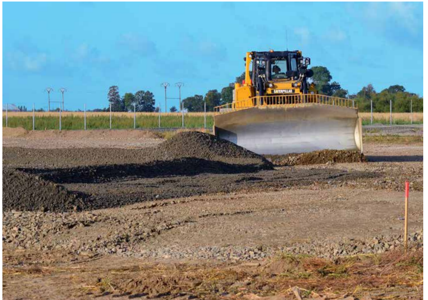
Microsofts datacenter i Staffanstorp blir den största företagsetableringen i Staffanstorp någonsin.
