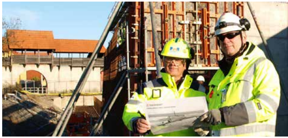
Fundamenten till stationsbron i Hjärup och stödmuren mot Banvallsvägen står nu färdiggjutna på plats. Här den ansvarige projektchefen hos fyrsparbygets entreprenör, Joint Venture NCC/OHL Anders Söreklint tillsammans med Trafikverkets projektkoordinator Petter Holmqvist.
